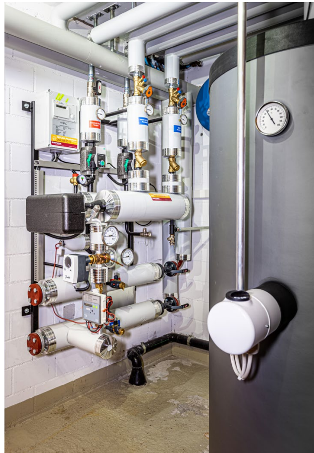
Eine neue Hausstation mit Kombiventil und integrierter Wärmeübergabestelle
