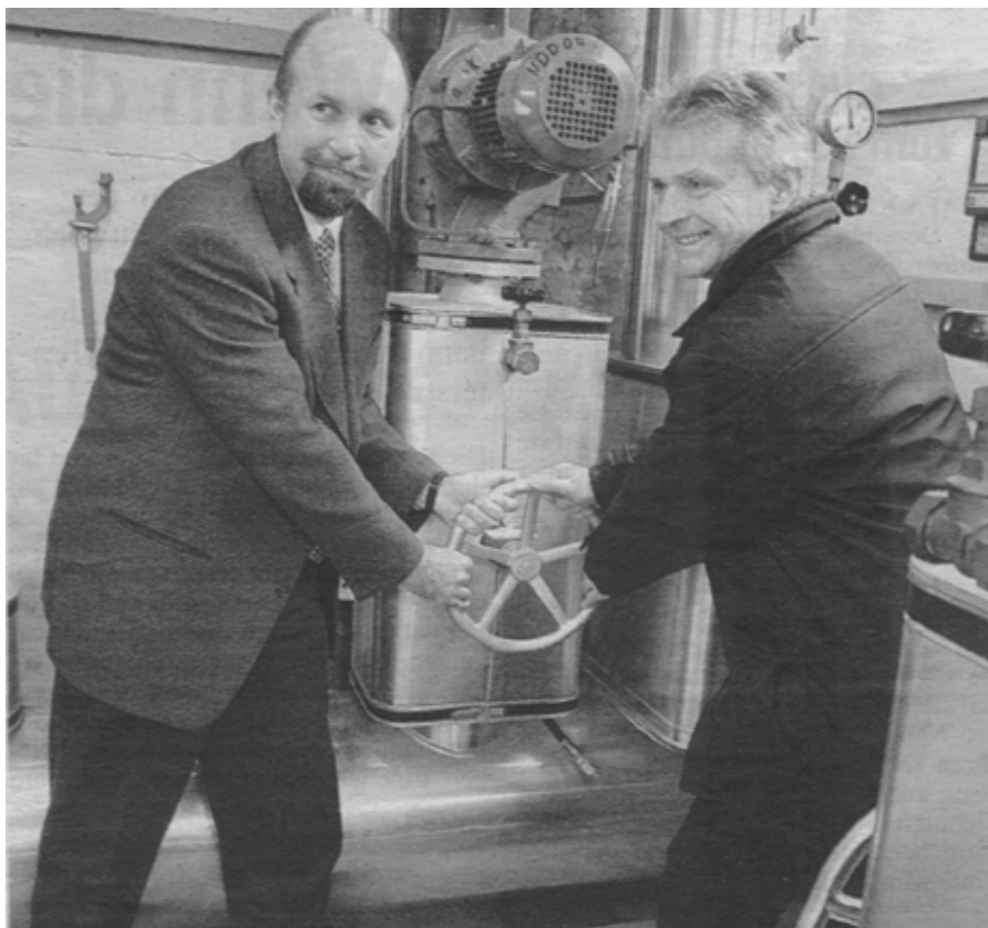
Zusammenschluss: Daniel Zimmermann (links), Präsident der REFUNA AG, und Hans Killer, Präsident der Fernwärme Siggenthal AG, in der ABB-Heizzentrale Ennetturgi nach dem Entscheid, die beiden Netze im Herbst 2003 zu verbinden. „Botschaft“ vom 21. Dezember 2002
