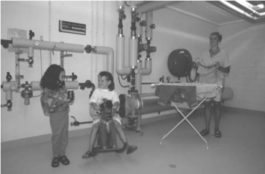
Ein für die Fernwärme typischer Heizkeller mit vielfältigen Nutzungsmöglichkeiten
