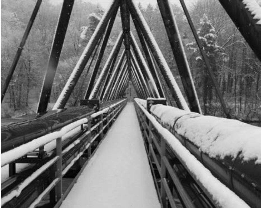
Die Rohrbrücke mit den Refunaleitungen beim Kernkraftwerk Beznau symbolisiert die Verbindung der Region Unteres Aaretal
