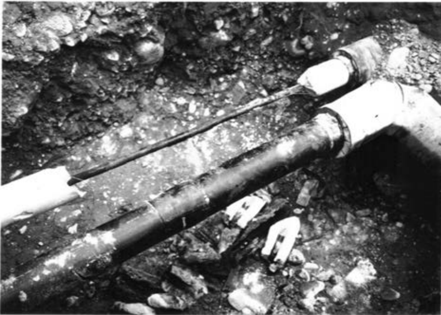
Leckage am Haldenweg in Würenlingen. Hauszufuhr, Isolation entfernt.
