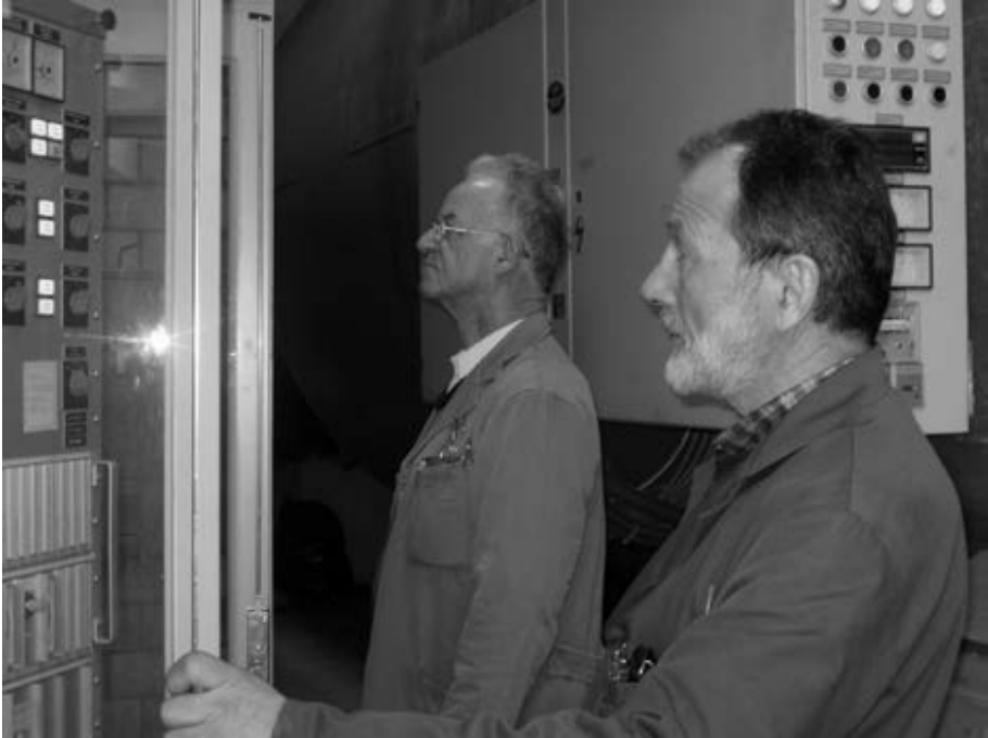
Rolf Scheidegger (links) und Peter Knecht bei Kontrollen im Reserveheizwerk Nord
