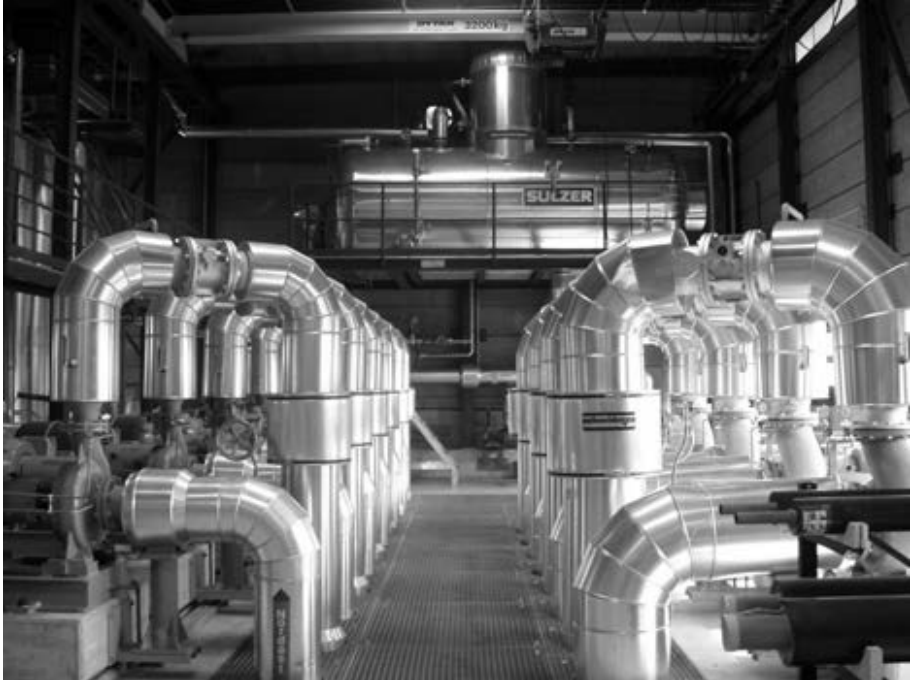
Hauptpumpenstation der Refuna im Kernkraftwerk Beznau
