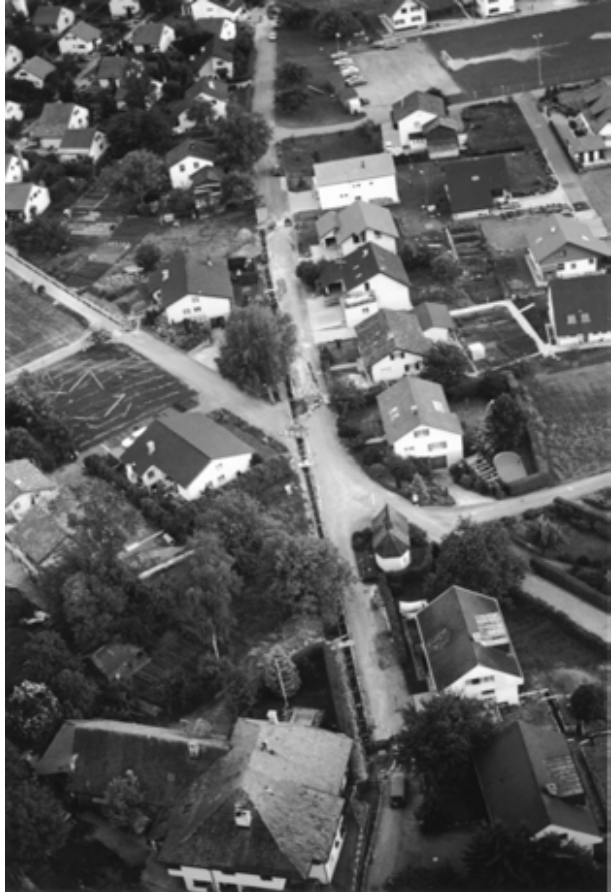
Bau der Ortsnetz- leitungen an der Kreuzung Römerstrasse und Rennweg in Würenlingen
