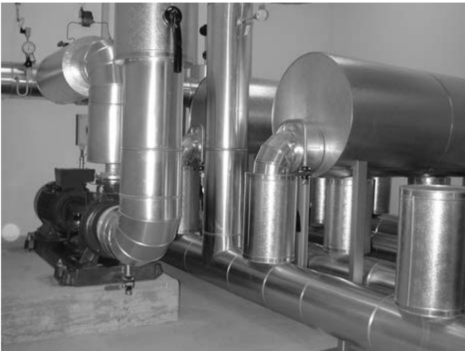
Kopplungsstelle der Fernwärmenetze der REFUNA AG und der FWS AG im Gebiet der Gemeinde Untersiggenthal
