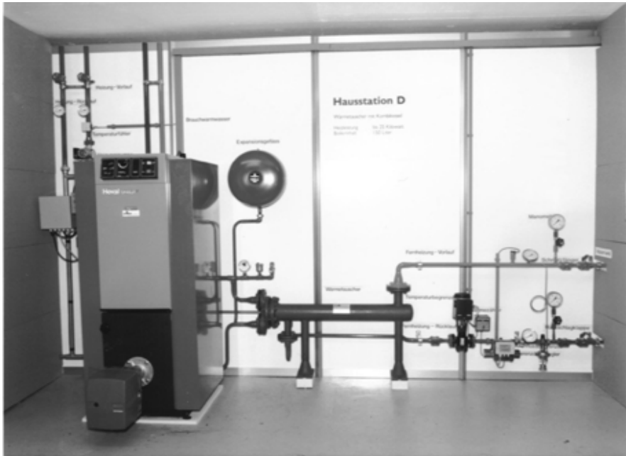
Ausstellung von Hausstationen für die Refuna-Kunden im Jahr 1983. Im Bild die bivalente Station mit Reserve-Ölbrenner für den möglichen Ausfall der Refuna.
